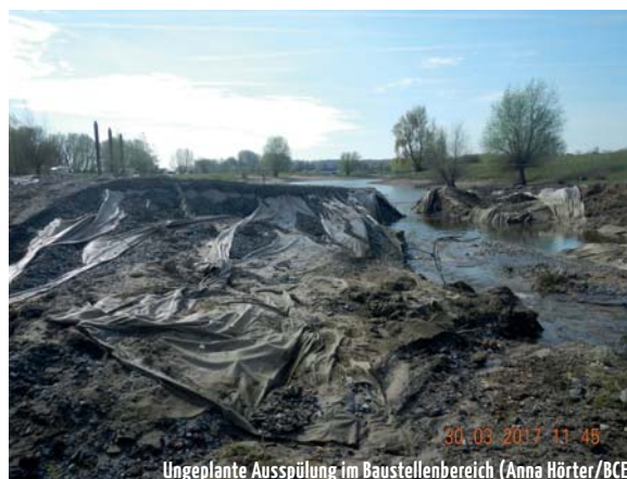
Ungeplante Ausspülung im Baustellenbereich (Anna Hörter/BCE)
